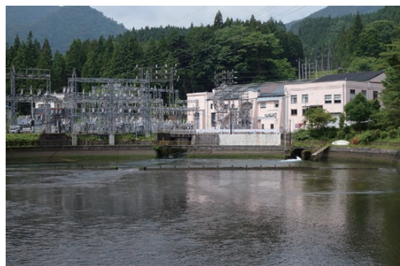
古河日光発電(株)の水力発電(細尾発電所)
