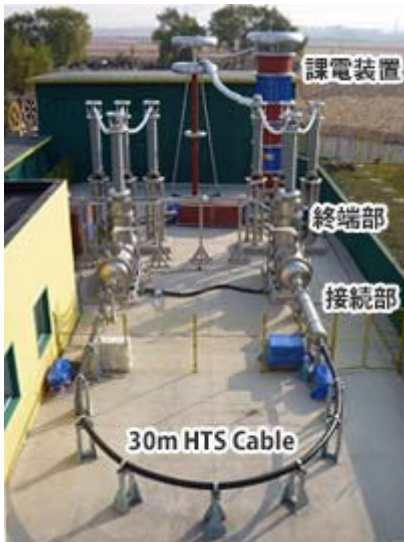
30m 275kV 超電導ケーブル実証試験(瀋陽市)
