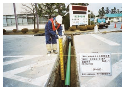
都市ガス配管導入状況
