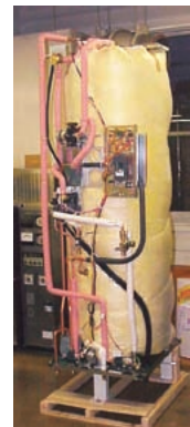
エコキュート配管
