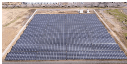
三重事業所が設置した太陽光発電パネル(2021年4月稼働開始)
