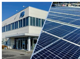
古河電池(株)が設置した太陽光発電パネル (2022年4月稼働開始)
