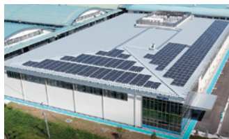
東京特殊電線(株)が設置した太陽光発電パネル (2021年1月稼働開始)
